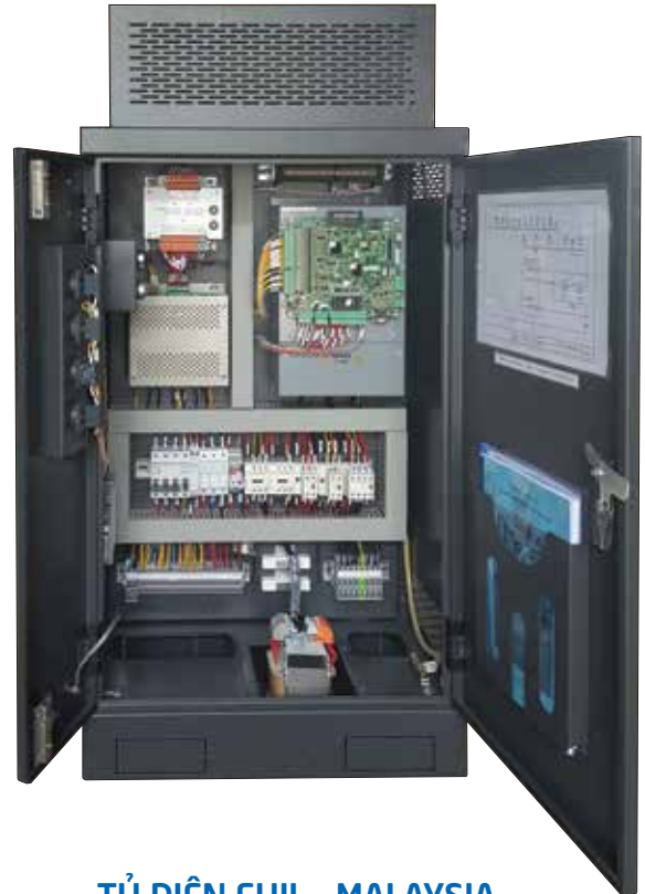
TỦ ĐIỆN FUJI - MALAYSIA (W600 x D330 x H1150)
